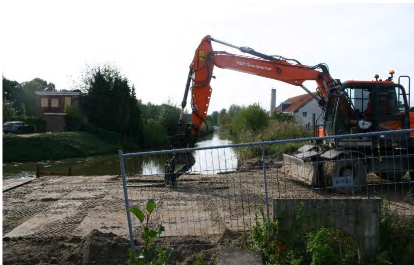
Figuur 4.1.7. Deelgebied 6; kanaal. Rechts de bouwplaats en voormalige suikerfabriek, links Gen. Allenweg 2a.
