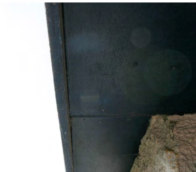
Figuur 4.4.2. De gootbetimmering sluit overal nauw aan; er is hierdoor geen ruimte waar vleermuizen in kunnen vliegen.
